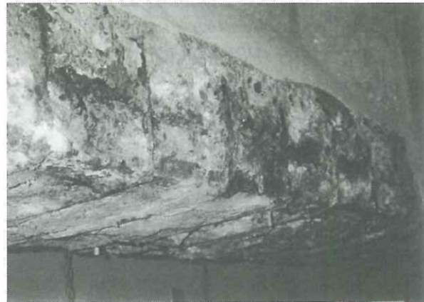
写真4 はつり後の鉄筋腐食状況
