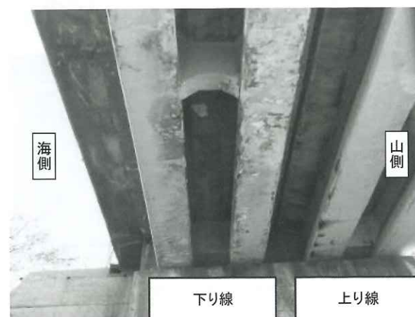
写真7 表面被覆工劣化の状況
