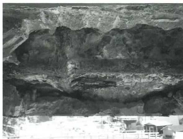
写真9 上り線の鉄筋状態
