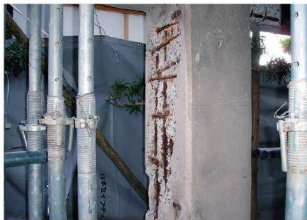
柱の劣化状況
